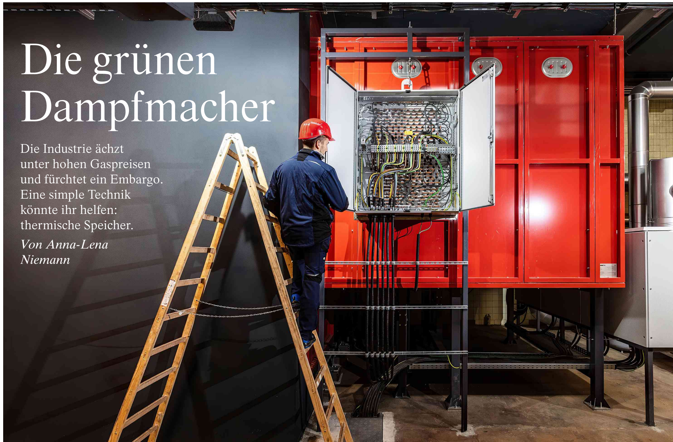
Anschlussfähig: Im alten Heizhaus eines Berliner Quartiers sorgt der mit Stahlkernen gefüllte Speicher von Lumenion für heißes Wasser. Er lädt, wenn viel Wind und Sonne die Strompreise drücken.
