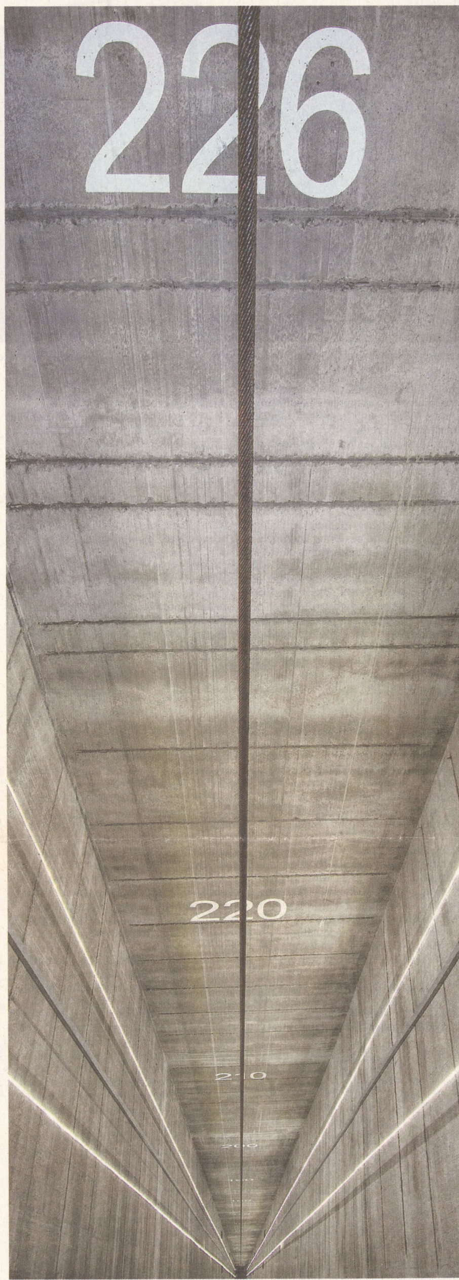
Blick ins Innere: Mehr als 200 Meter wird der Aufzugstestturm in Rottweil hoch sein, hier wird innovative Technik geprüft.
